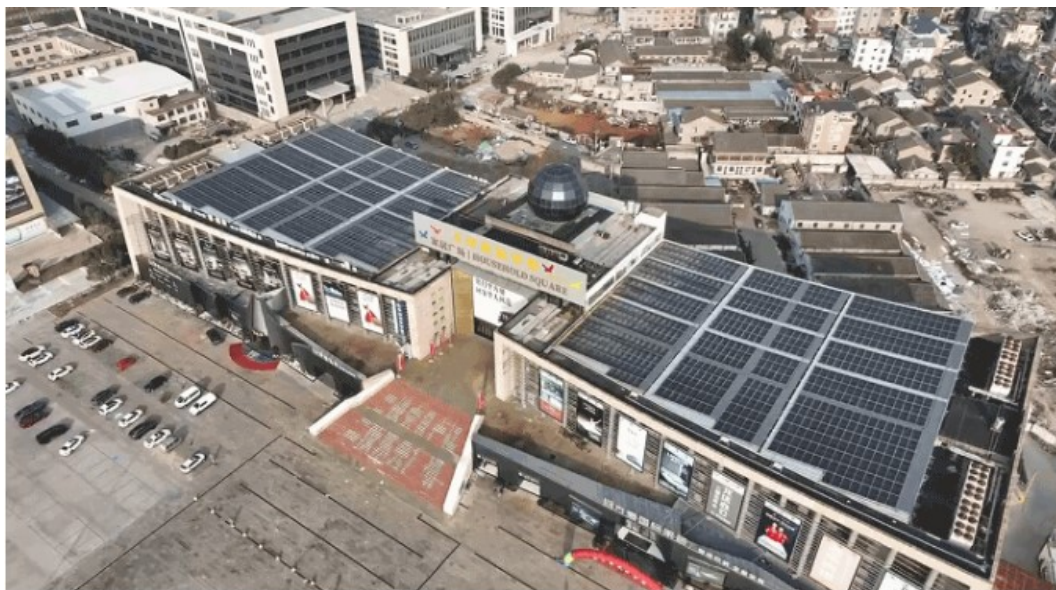
图 7.2 玉环市光储充放电站实景图
